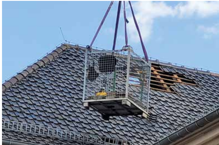
Réparation de la toiture de l'église à la suite d'un orage violent par l'entreprise Dos Santos de Blodelsheim Juillet 2023.
